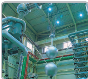
Испытание импульсом в лаборатории высоких напряжений
